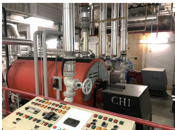
Chaufferie de la Cité des Provinces
