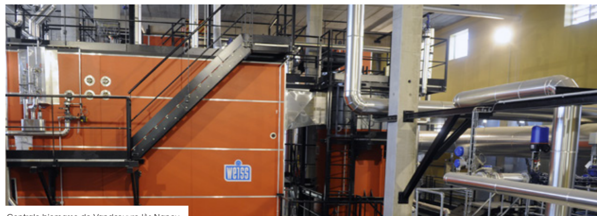
Centrale biomasse de Vandœuvre-lès-Nancy
