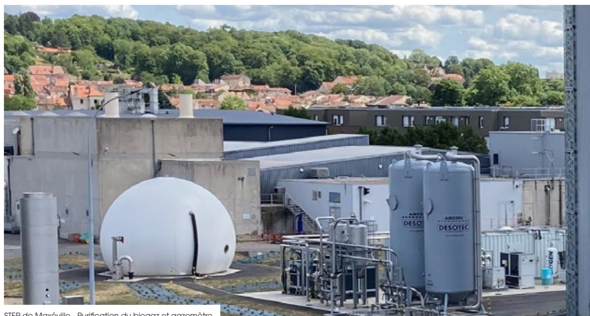
STEP de Maxéville - Purification du biogaz et gazomètre
